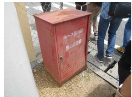
写真1 自治会のホース格納庫
